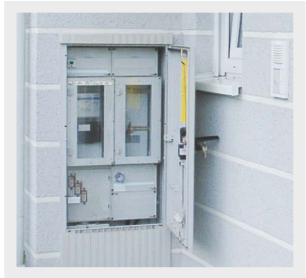
Hausanschluss- und Zählerschrank (bauseits)
